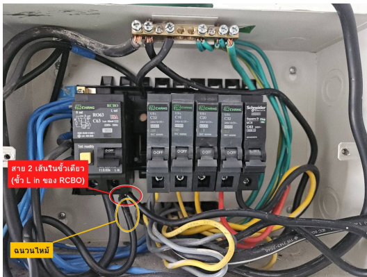
ตู้ไฟ วงสีแดงคือหัวไฟเข้าของ RCBO วงสีเหลืองคือสายที่มีรอยไหม้ด้านล่าง
