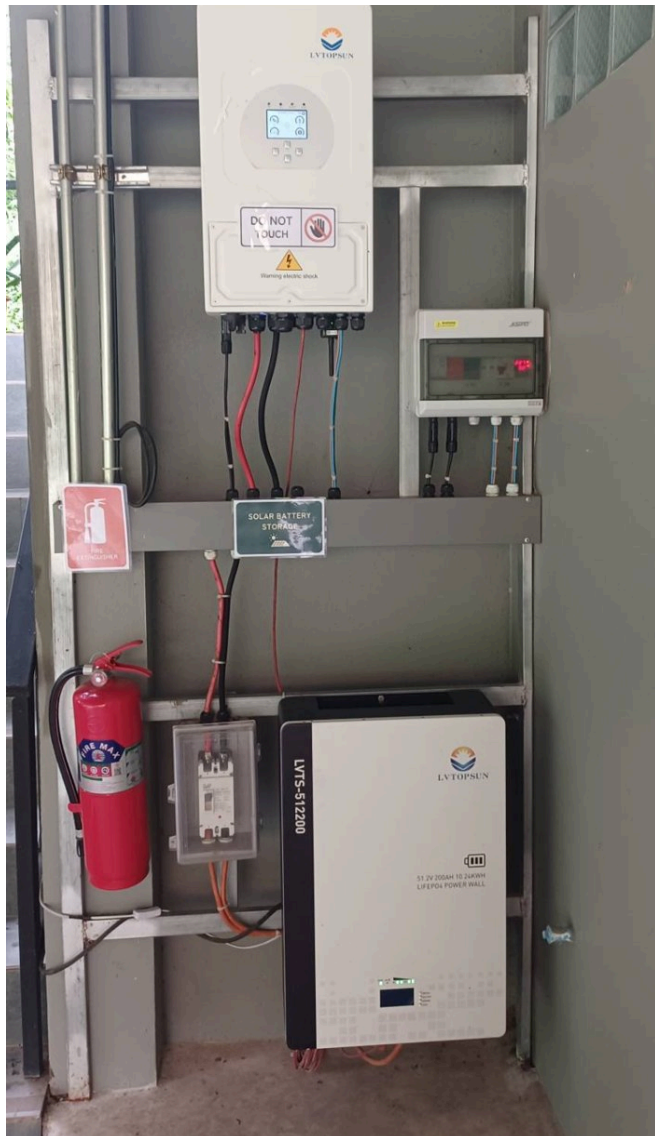
สภาพเดิม: แบตเตอรี่ 1 ลูก ถัดดับเพลิง และตู้เบรกเกอร์ DC ในช่องติดตั้ง
