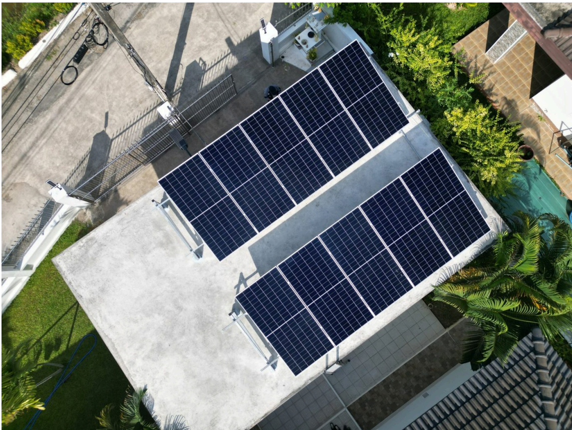
ภาพมุมสูงจากโดรนของระบบที่ติดตั้ง: แผงสองชุด ชุดละ 5 แผง บนพื้นหลังคาคอนกรีตเรียบ
