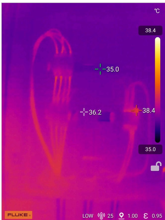
Image thermique du coffret électrique (Fluke, émissivité 0.95).
