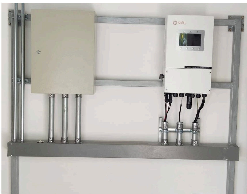
Coffret électrique (à gauche) et onduleur hybride Solis (à droite) sur le châssis en acier galvanisé.
