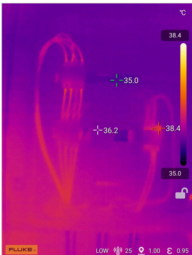
Warmtebeeld van de schakelkast (Fluke, emissiviteit 0.95).
