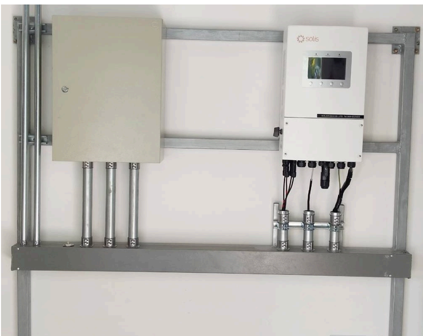
ตู้ควบคุม (ซ้าย) และอินเวอร์เตอร์ไฮบริด Solis (ขวา) บนโครงเหล็กชุบกัลวาไนซ์
