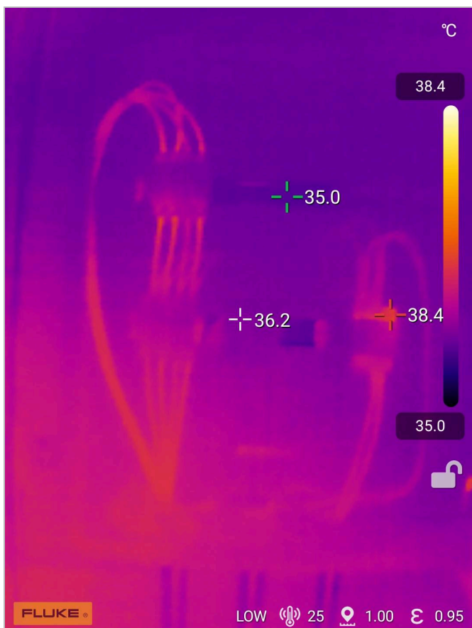
ภาพถ่ายความร้อนของตู้ควบคุม (Fluke, emissivity 0.95)
