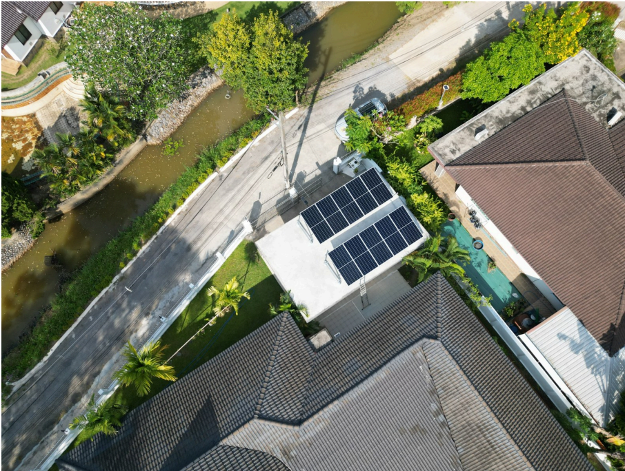
แผง 10 แผง (6.500 kWp) บนหลังคาโรงจอดรถ ภาพมุมสูงหลังติดตั้งแล้วเสร็จ
